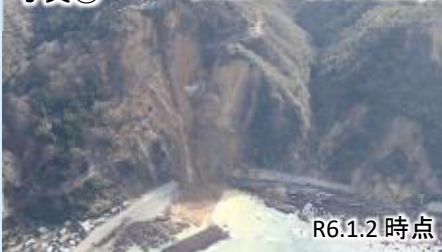
写真③ 国道249号法面崩落
